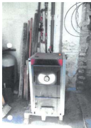
Špatná fotodokumentace - není vidět napojení na komín
