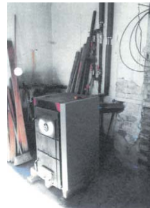
Správná fotodokumentace - kotel zapojený na komín a otopnou soustavu
